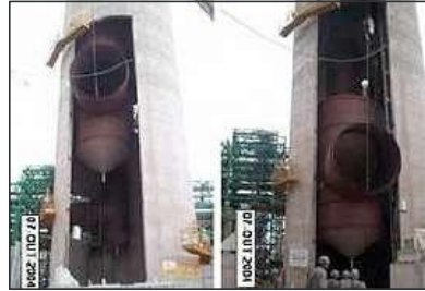
Içamento de dutos da chaminé de caldeira da Veracel Celulose sem utilização de guindastes. Foto: Imetame.
